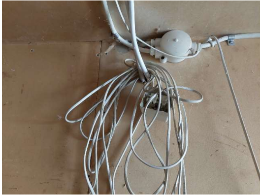
G19 ej fackmannamässigt utfört
