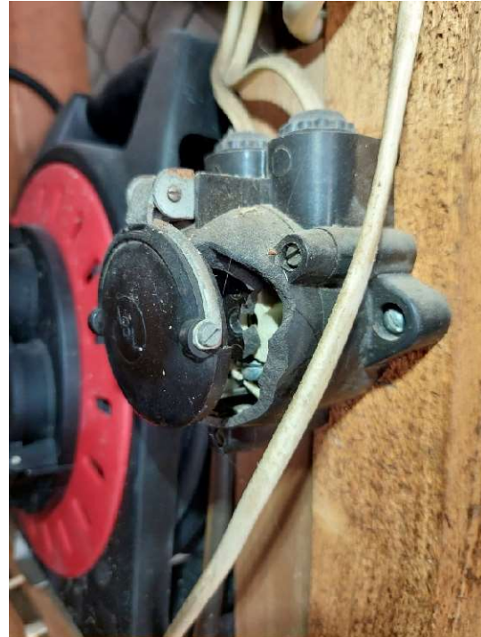
G40 trasigt vägguttag
