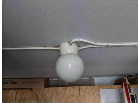
G48 ej fackmannamässigt utfört
