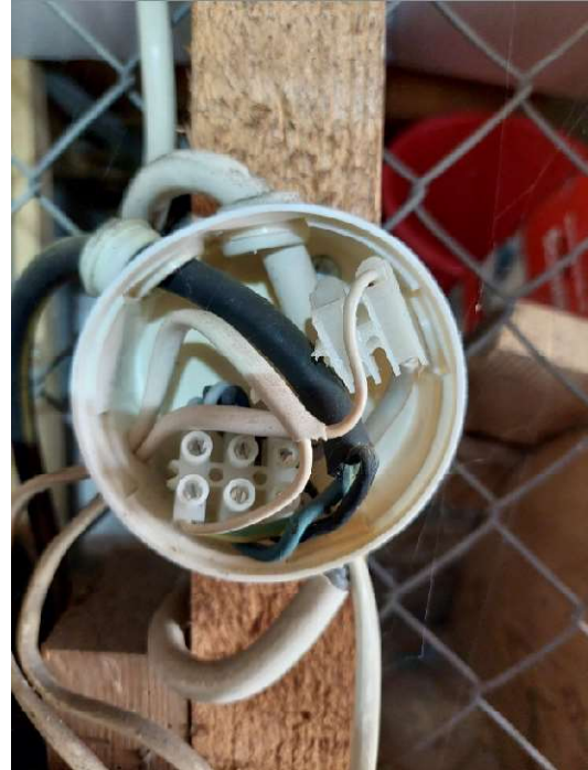
G40 ej fackmannamässigt utfört
