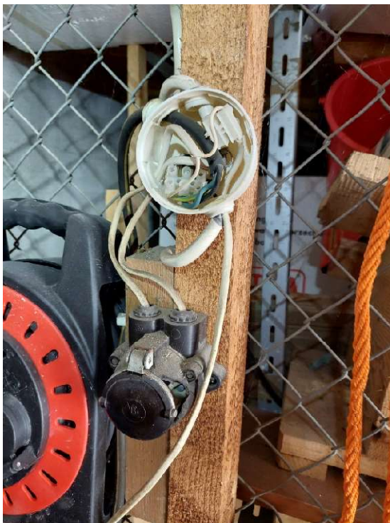
G40 ej fackmannamässigt utfört
