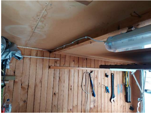
G44 ej fackmannamässigt utfört
