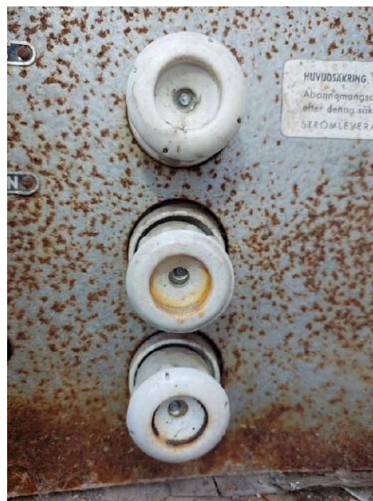
Fasadmätarskåp glas saknas i propphuv
