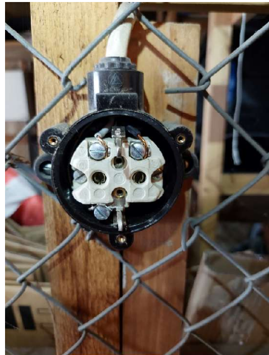
G35 vägguttag översyn
