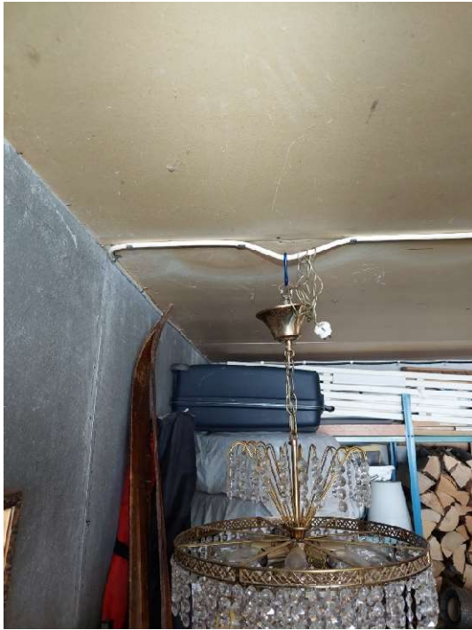
G32 risk för kabelbrott
