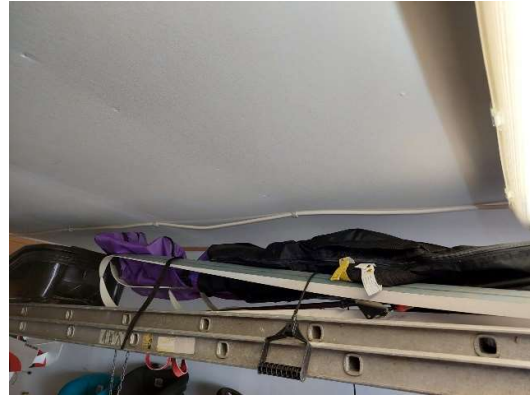
G48 ej fackmannamässigt utfört
